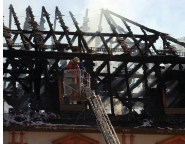
3. September 2004: Der ausgebrannte Dachstuhl am Morgen
